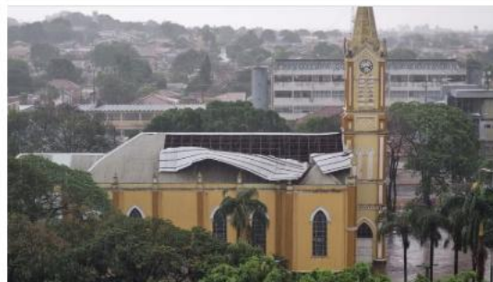
Defesa Civil/Reprodução Telhado da Igreja Matriz cedeu durante temporal em Rancharia (SP)
