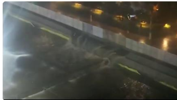
Muro de contenção desaba na obra da Linha 6 - Laranja do Metrô
