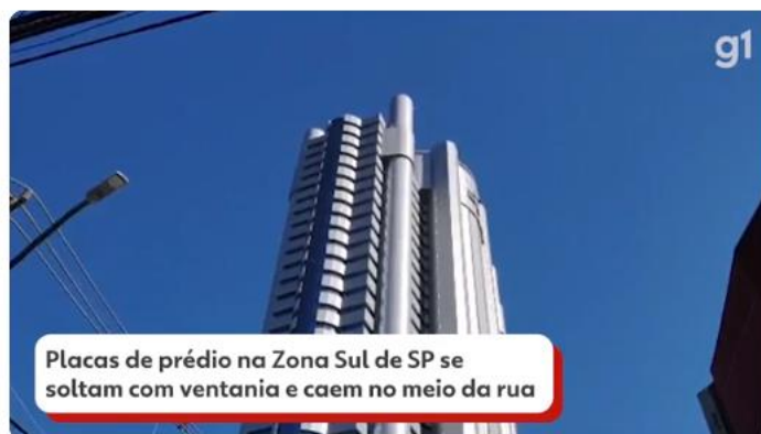
Placas de prédio na Zona Sul de SP se soltam com ventania e caem no meio da rua
