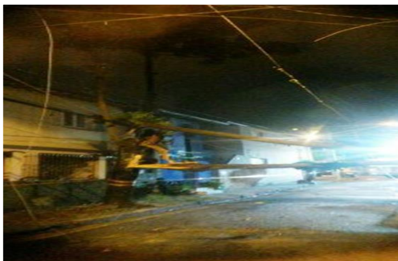
Queda de uma árvore de grande porte sobre a rede deixando fio de alta tensão partido na Av. Ararendá Circuito: GNA 103
