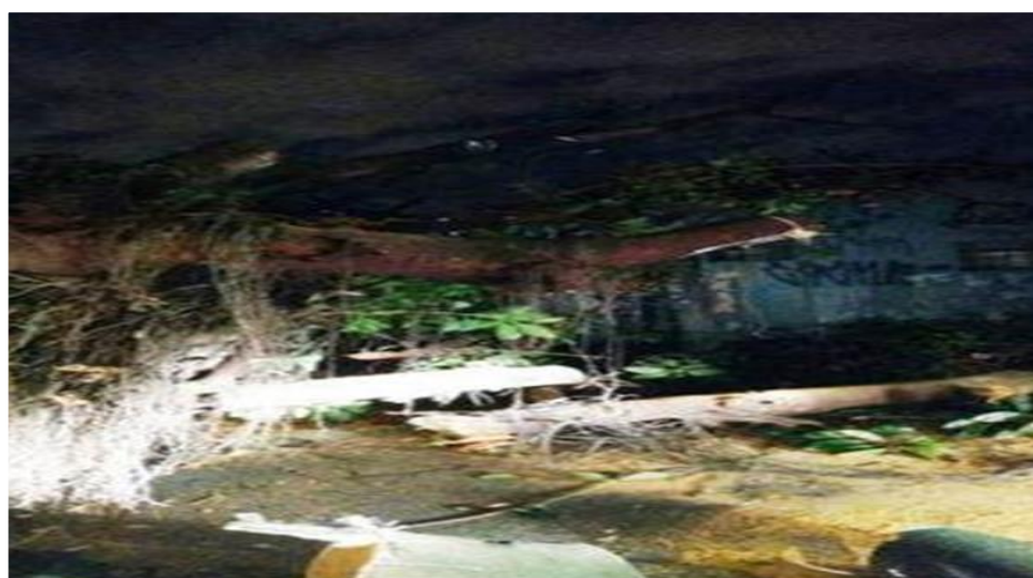
Queda de uma árvore de grande porte sobre a rede deixando fio de alta tensão partido na Rua Palmeira Laka Circuito: VTA 102
