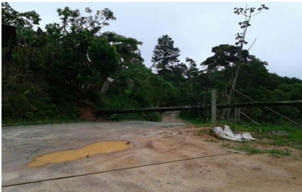
Queda de uma árvore de grande porte sobre a rede deixando fio de alta tensão partido na Rua sem nome Circuito: EGU 103
