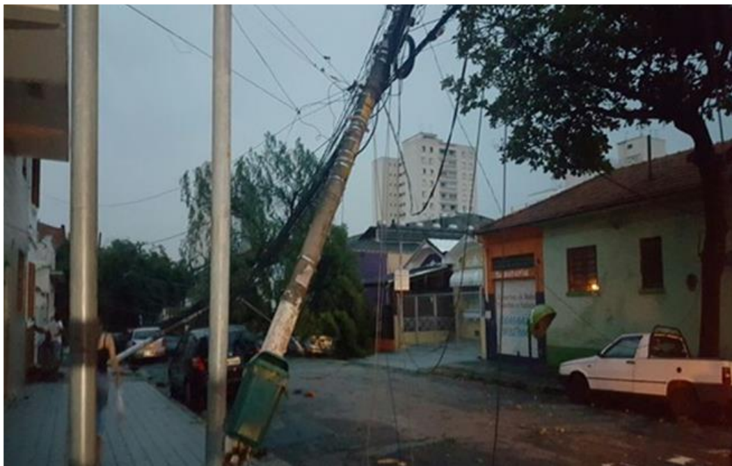
Queda de uma árvore de grande porte sobre a rede deixando fio de alta tensão partido na Rua Felix Guilen Circuito: LAP 103
