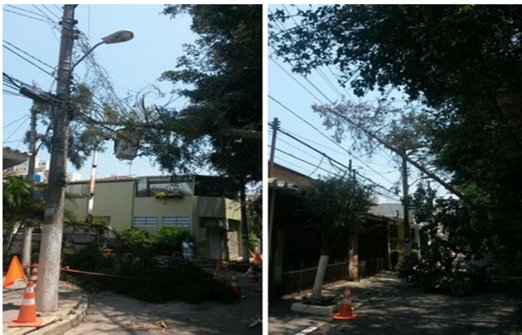
Queda de uma árvore de grande porte sobre a rede deixando fio de alta tensão partido na Rua Álvaro Alberto da Silva Circuito: PER 110
