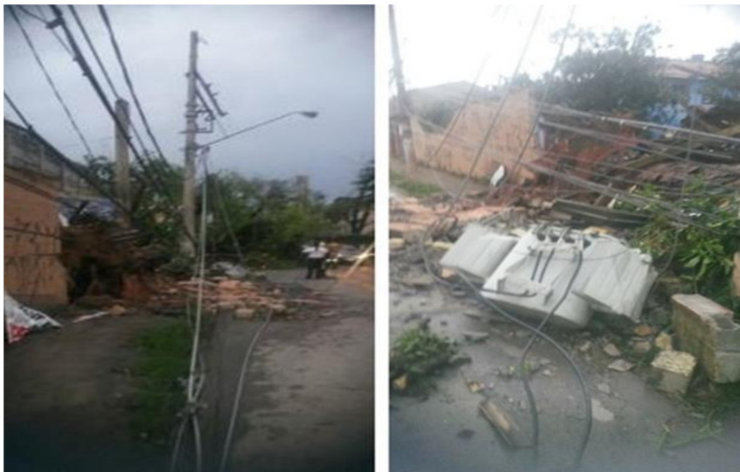
Queda de uma árvore de grande porte sobre a rede deixando fio de alta tensão partido no Condomínio Colibri Circuito: COT 114
