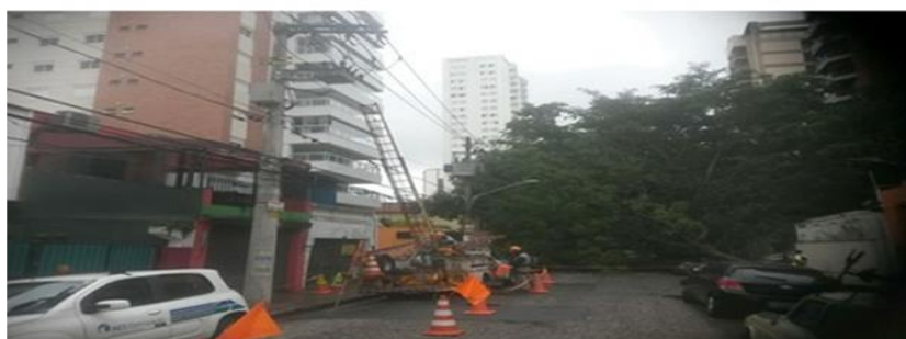
Queda de uma árvore de grande porte sobre a rede deixando fio de alta tensão partido na R Silva Correia Circuito: SAM 107
