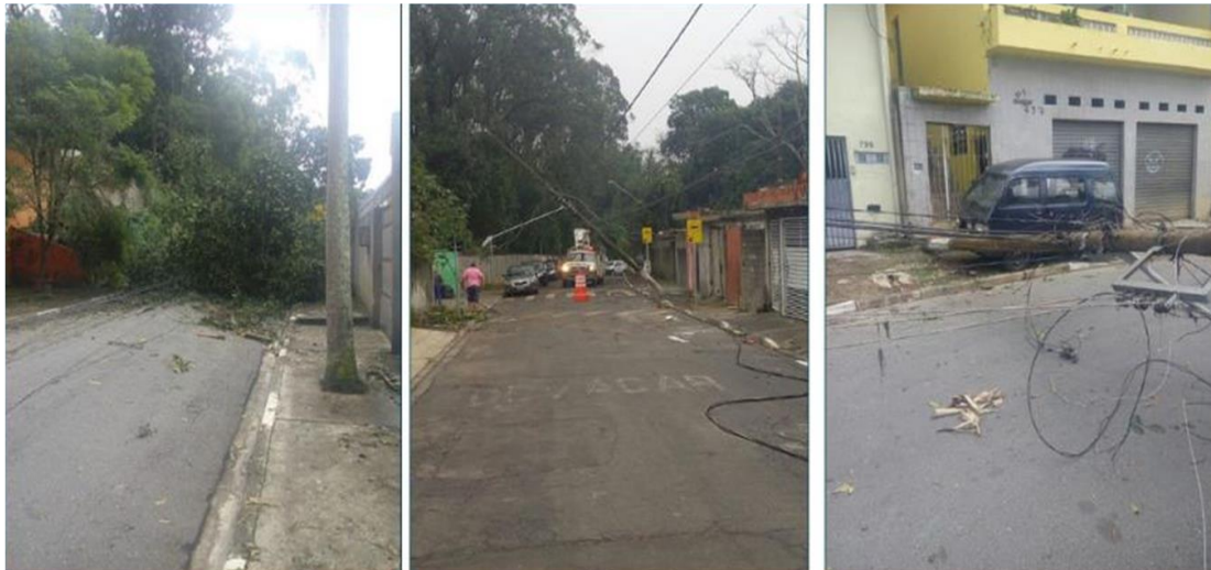
Queda de uma árvore de grande porte sobre a rede deixando fio de alta tensão partido na Rua Amaro Pontes - Circuito: PRE-0109
