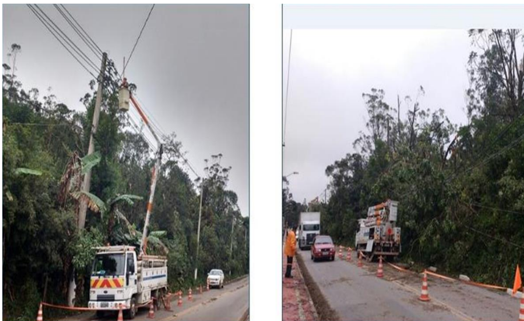
Queda de uma árvore de grande porte sobre a rede deixando fio de alta tensão partido na Estrada Marsilac Circuito: PRE-0104
