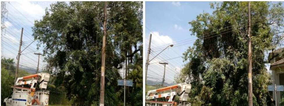
Queda de uma árvore de grande porte sobre a rede deixando fio de alta tensão partido na Alameda Surubim 9 Alphaville Santana de Parnaíba.
