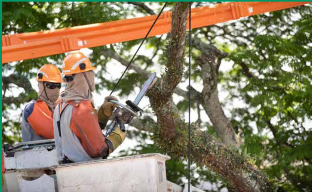
A poda deve contemplar ramos com derivações perigosas, soltos ou deteriorados
