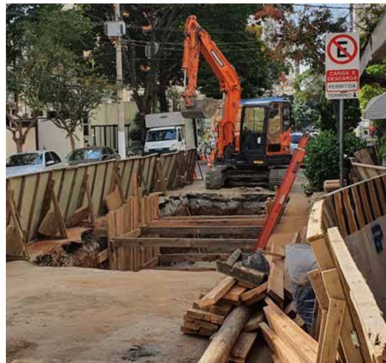
Aspecto da complexidade da implantação de rede elétrica subterrânea
