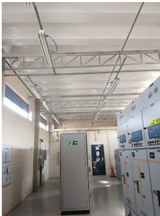
Figura 3 - Sala de Painéis.
