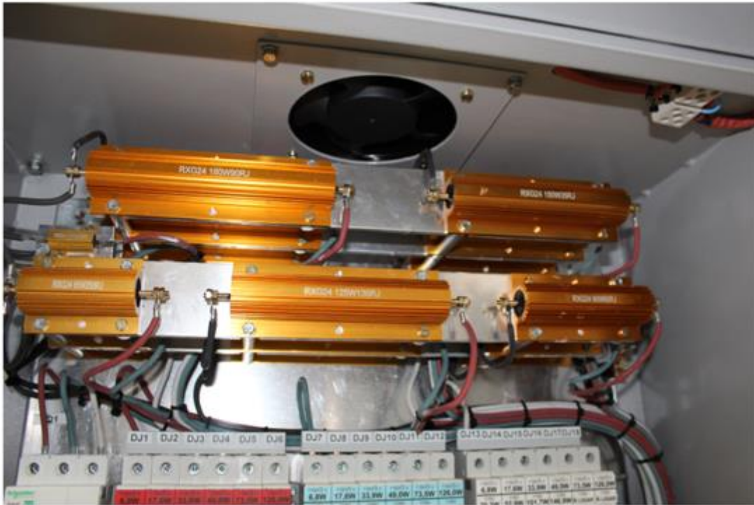
Figura 04: Vista Interna do Sistema de Monitoramento e Excitação do TP
