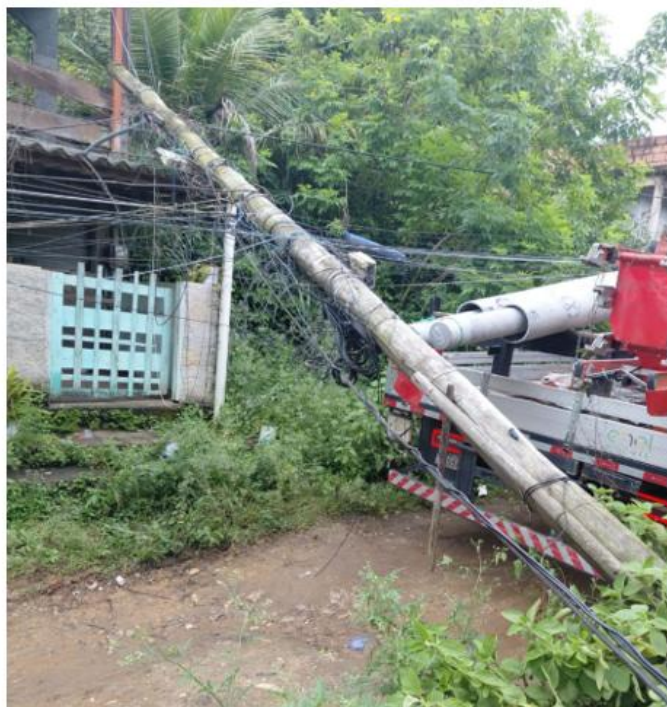
Necessário substituir um poste de 9M de madeira caído no meio da rua, dois postes após o transformador SG96629, tem apenas BT no poste
