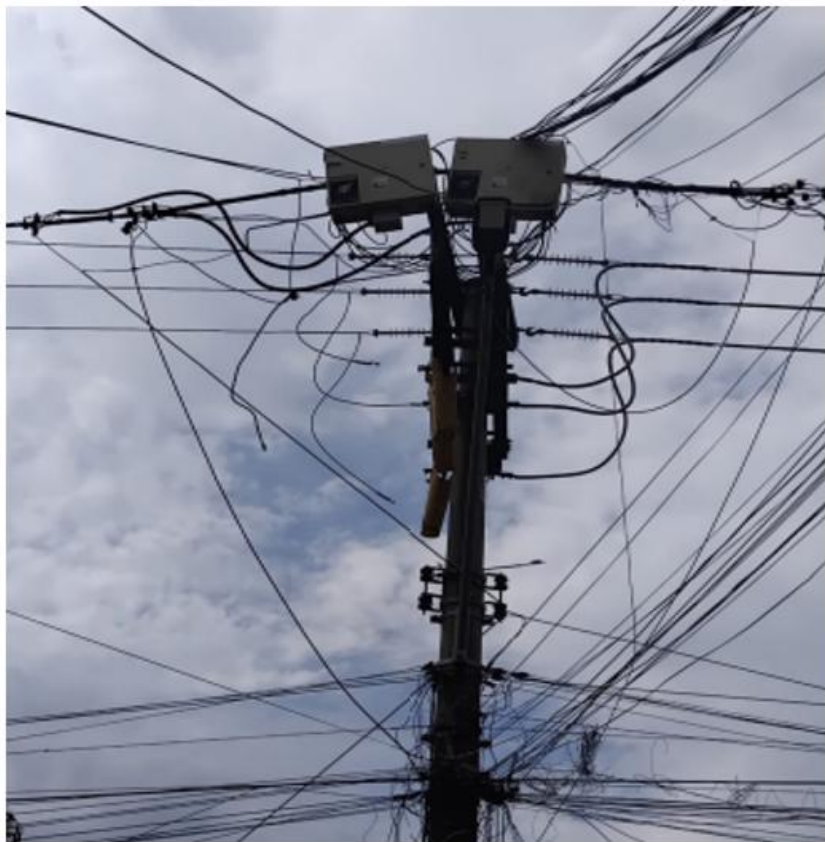
Necessário substituir chave faca sg90713 conexão cabo 50 XLPE com cabo 2al
