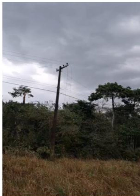
22/09/2025 – Causa do desarme do Religador SG59150 – Árvore tombada na rede
