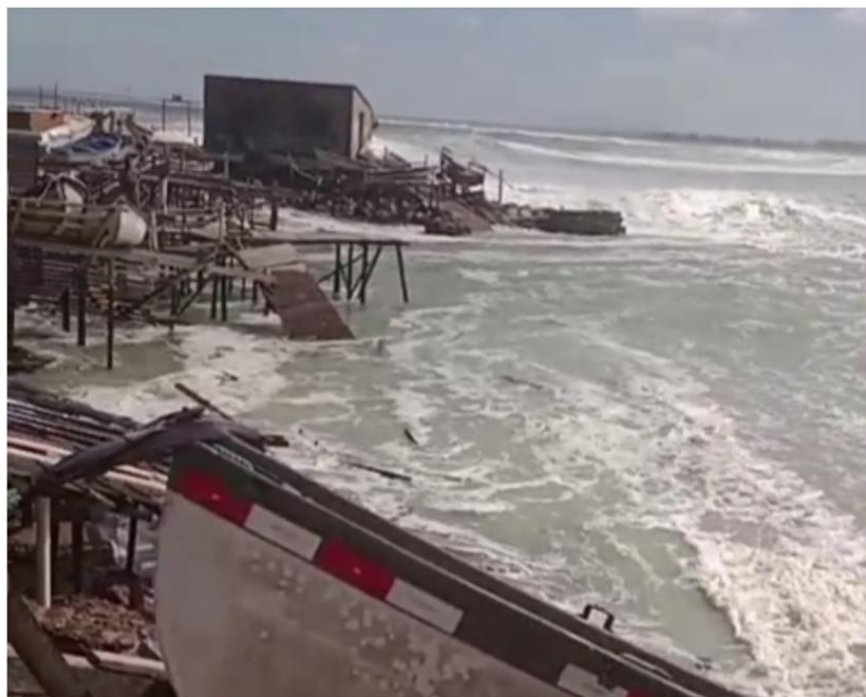
Estrutura na Praia dos Anjos cedeu com as fortes ondas que atingem o litoral do estado
