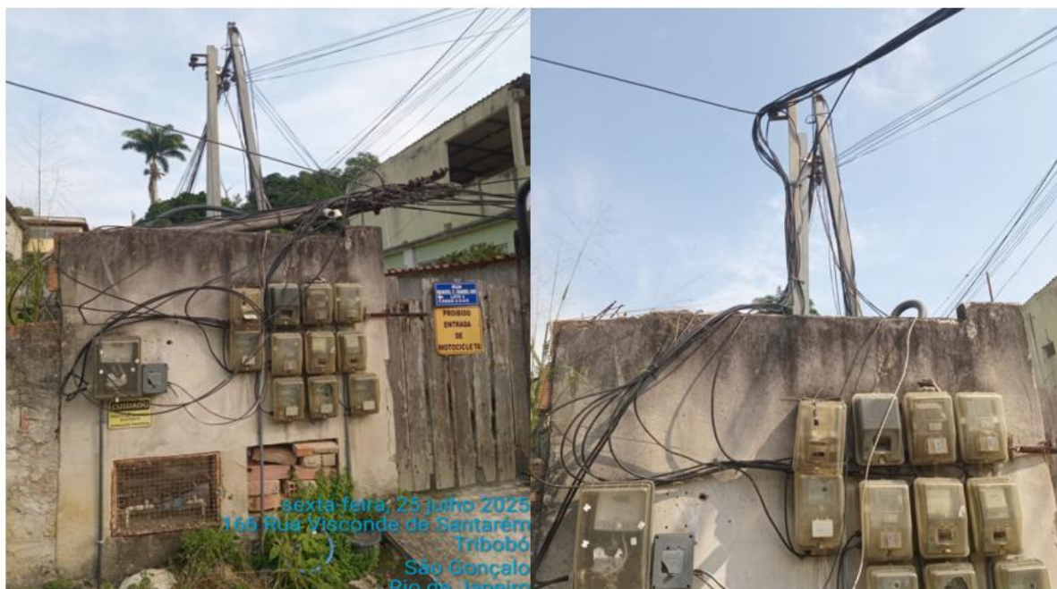
POSTE PADRÃO QUEBRADO- ZSL01-S210787- POSTE FOI RETIRADO
