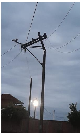
10/04/25 – Poste quebrado Tamoios – Cabo Frio
