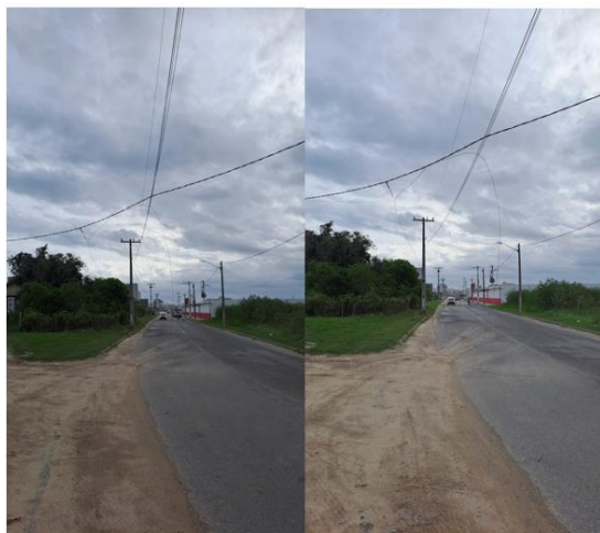
10/04/25 Cabo partido – SPA02 Risco isolado
