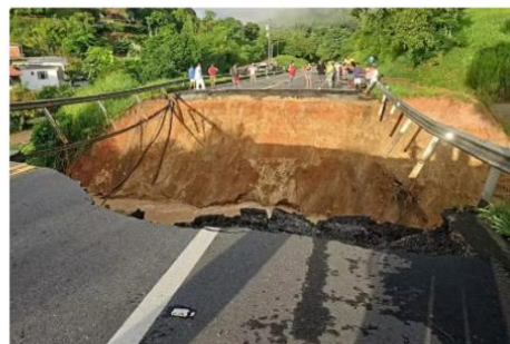
Afunda da BR-351 cedeu e teve que ser interditada devido a tempestade da última quinta-feira (21) Foto: PEP
