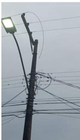
Região dos Lagos – 04/12/23 Cabos Partidos
