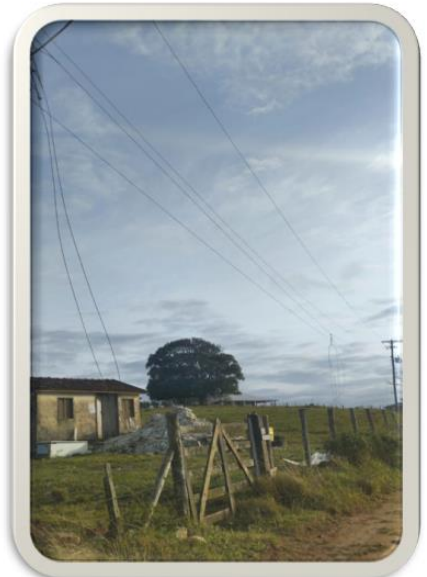
Registro Polo Lagos – Poste tombado Data: 11/08/2023
