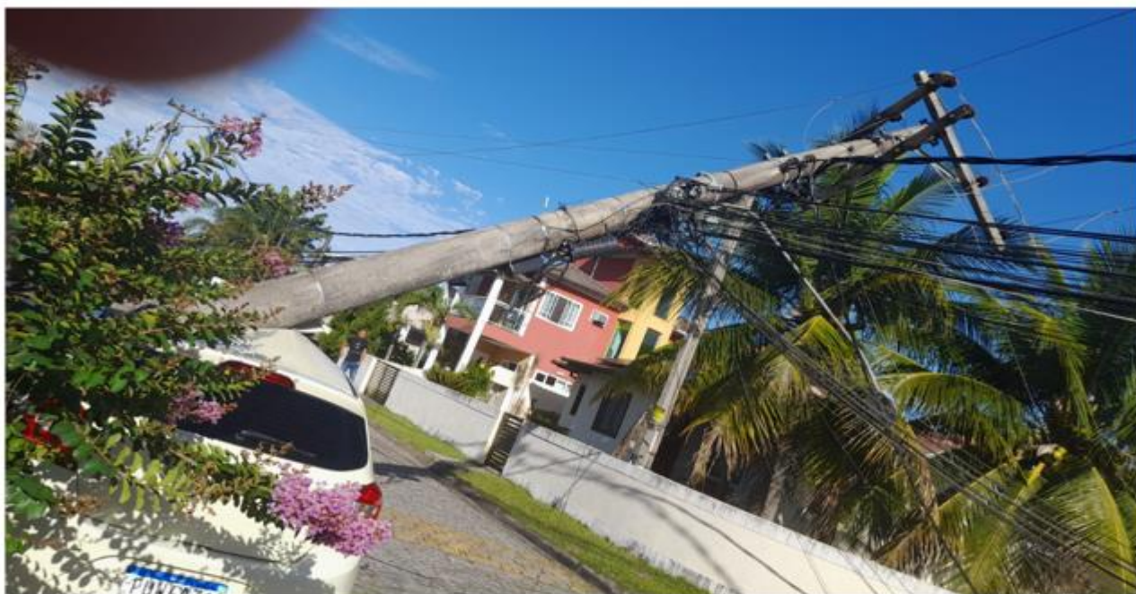
Pólo de Niterói - Poste tombado – Causada por vento Data: 13/12/2022
