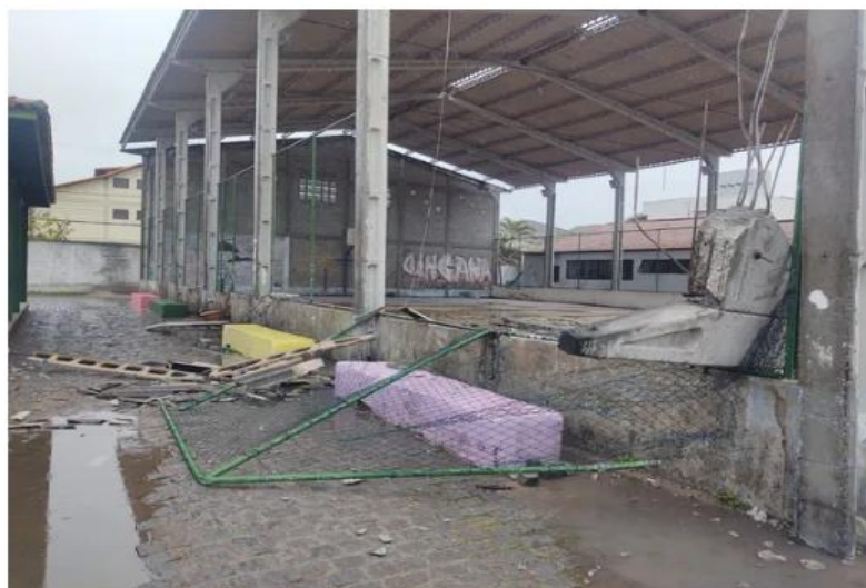
Telhado de quadra esportiva de escola em Cabo Frio desaba por conta da chuva — Foto: Arquivo pessoal
