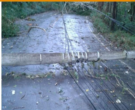
Queda de poste interdita estrada no Brejal
