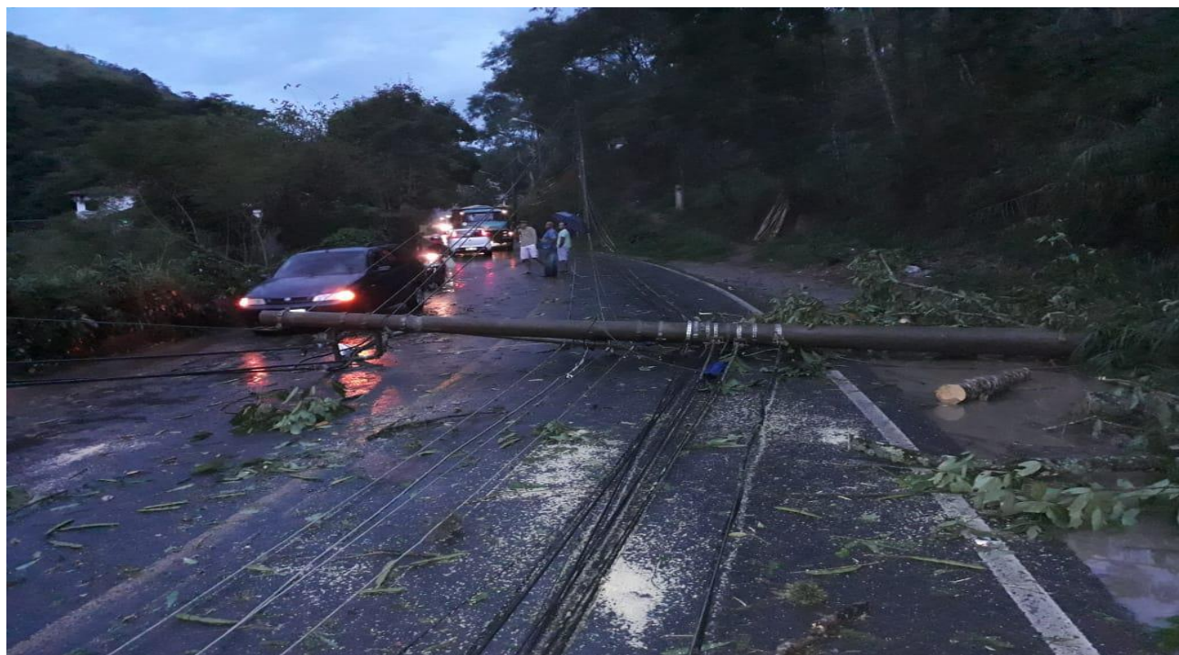
Desarme Religador PE63071 Queda de árvore Queda de Poste e Condutor Partido Petrópolis
