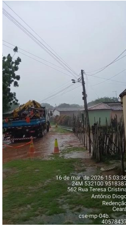
Figura 13. Foto registrada no dia 16/03/26 às 15:03 na localidade Redenção
