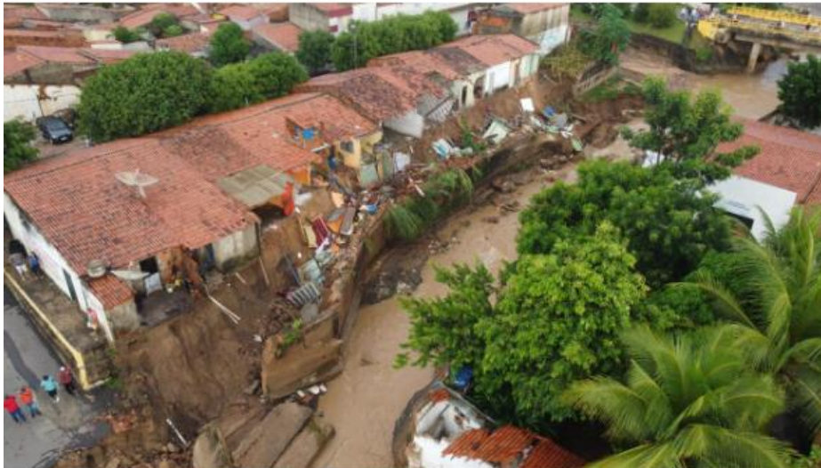
Legenda: Paredão de sustentação rompeu e casas foram afetadas Foto: Raony Pinheiro/Arquivo Pessoal
