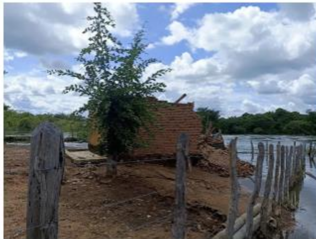
Cheia do Açude Ubaldinho, em Cedro, afeta estrutura de residências próximas. Foto: Corpo de Bombeiros/Reprodução
