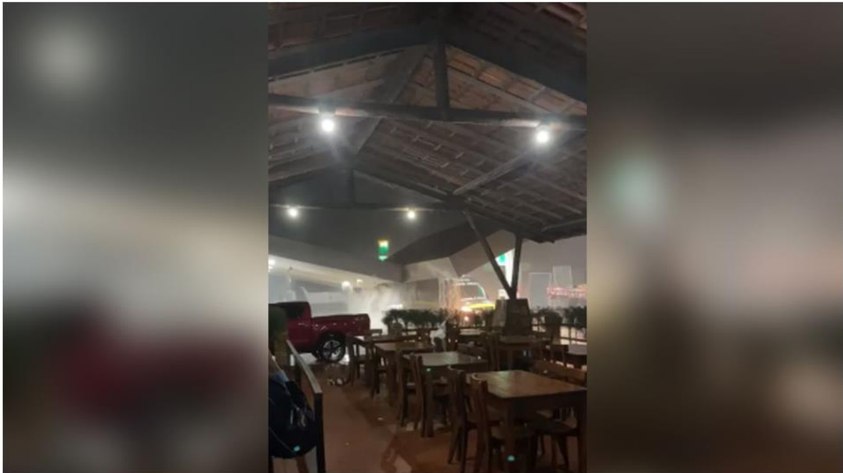
Legenda: No município de Fortim a precipitação de 43 mm fez o teto do estabelecimento ceder parcialmente Foto: reprodução
