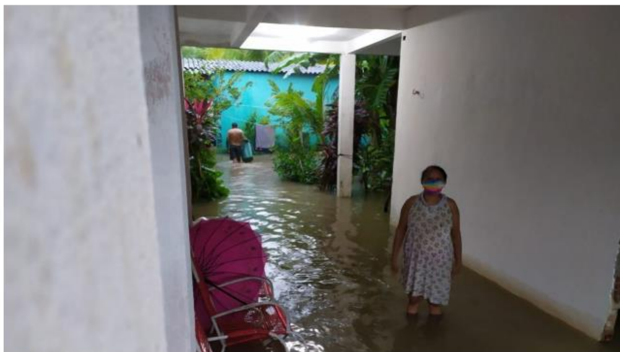
Legenda: Água da chuva invadiu residência no bairro José Walter Foto: Hállsson Ferreira
